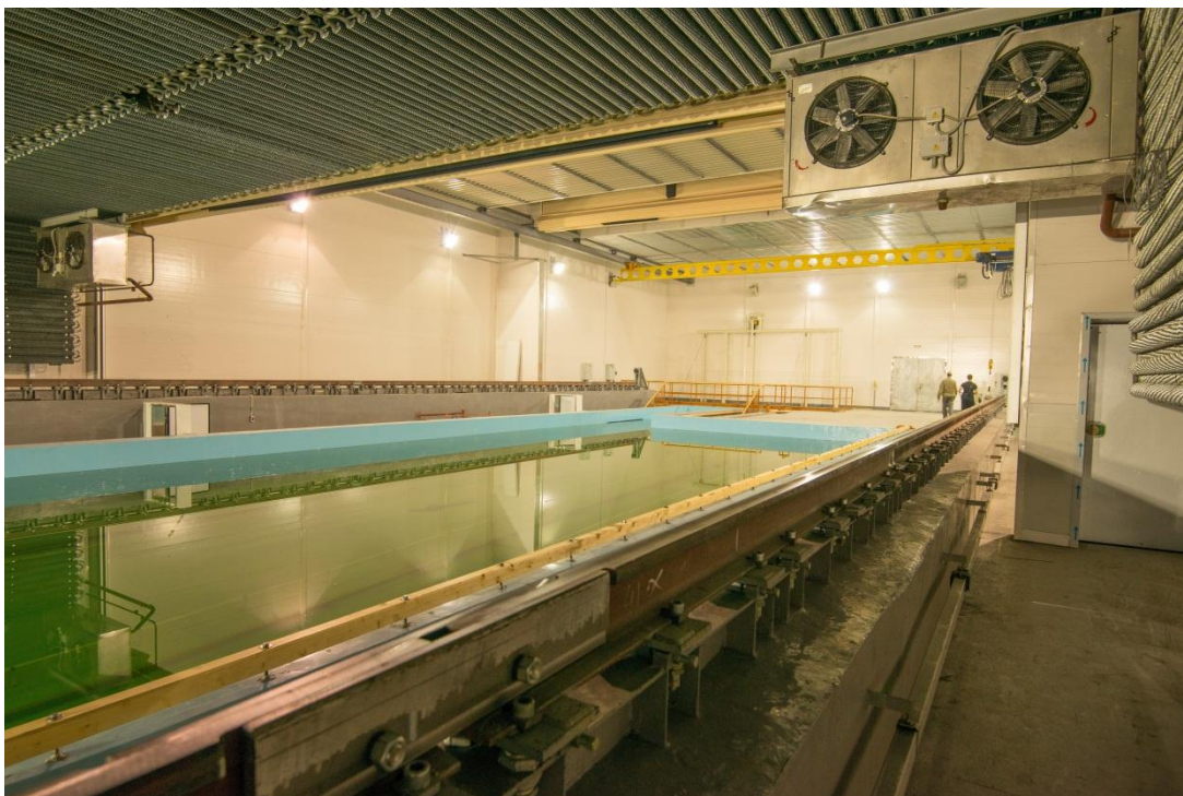
Система охлаждения воздуха в ледовой камере нового ледового бассейна
